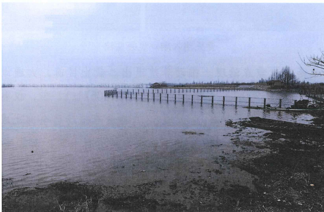
明山电排渠入湖口钢制拦污栅
