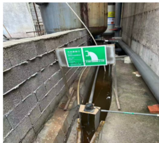
污水处理站排放口
