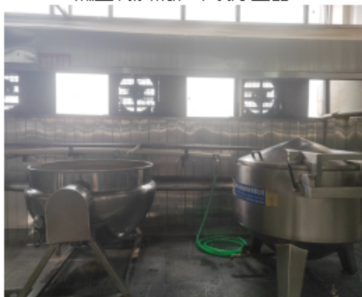
车间内排气扇
