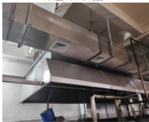
油炸工序废气收集措施
