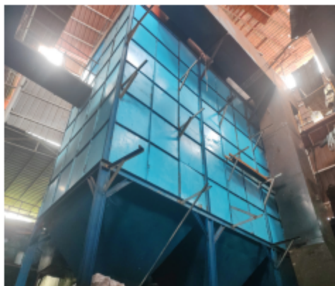
燃生物质锅炉布袋除尘器
