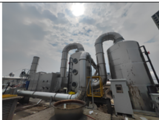
油炸工序废气处理设施及排气筒
