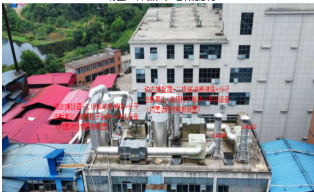
2 栋卤制车间废气处理设施总览
