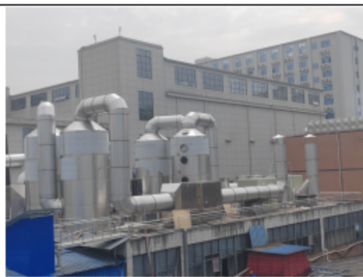
卤制车间废气处理设施及排气筒
