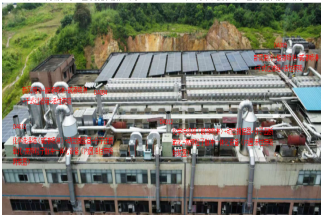
1 栋生产车间废气处理设施总览
