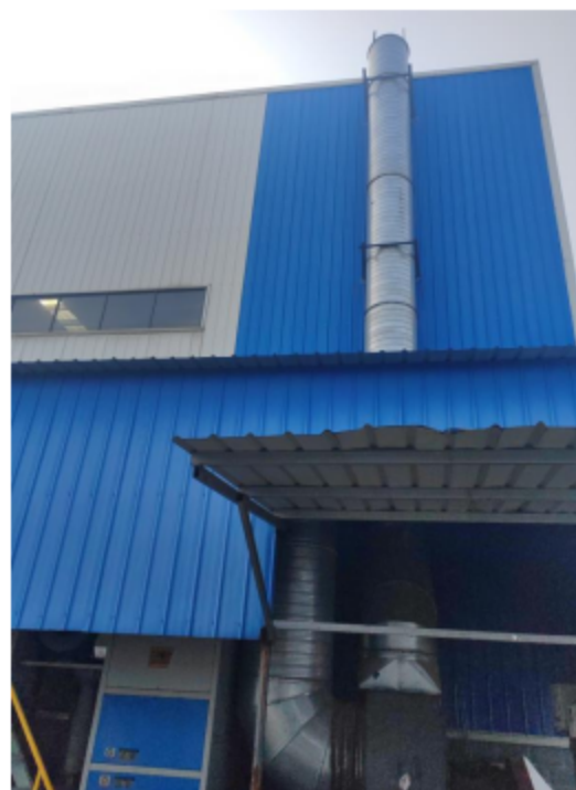
催化燃烧及废气排气筒
