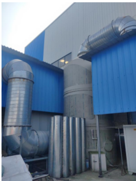
废气处理设施喷淋塔
