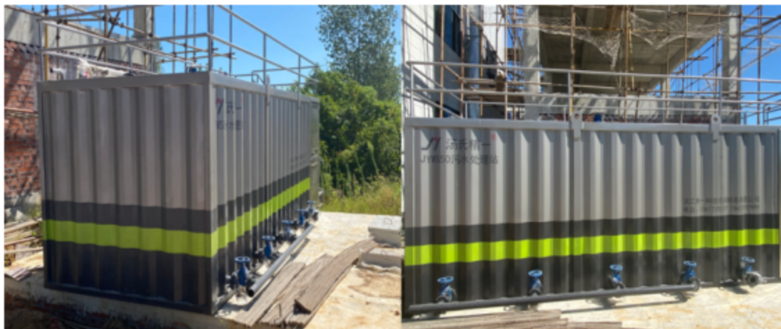
生活污水一体化处理设施
