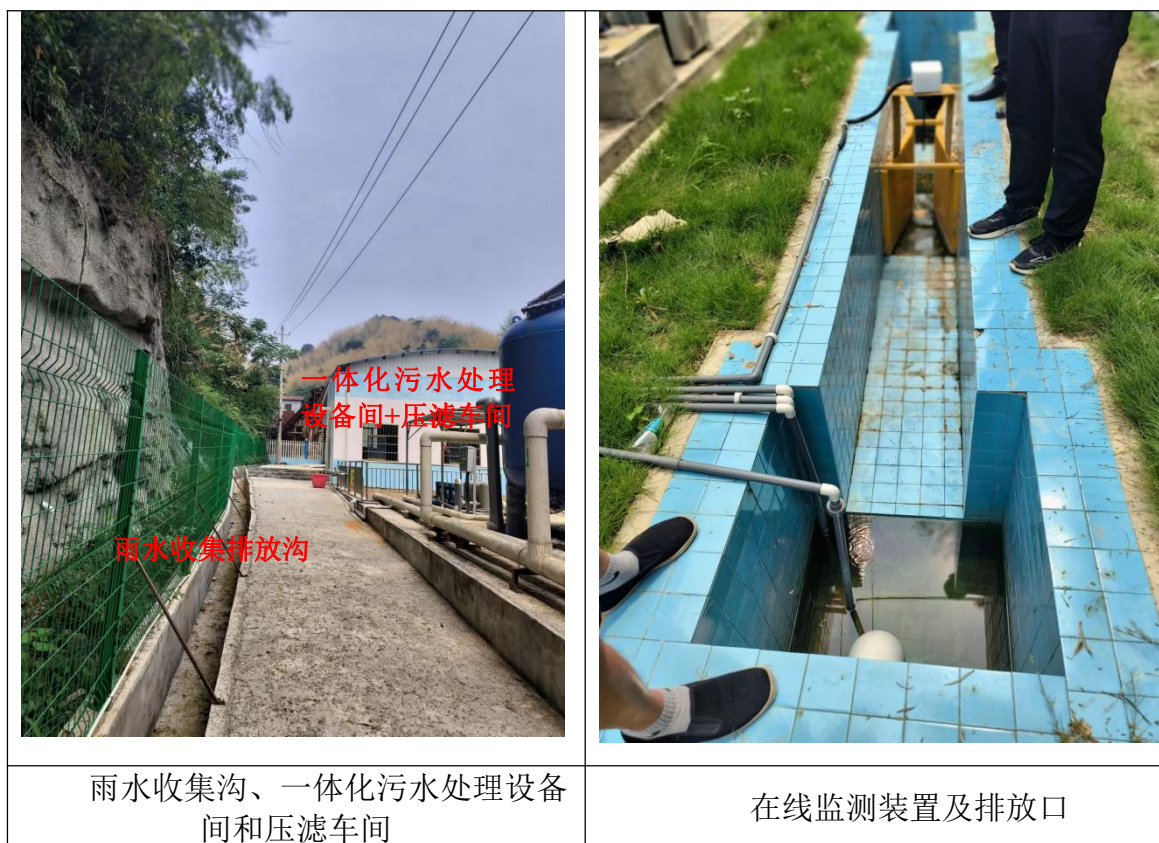
图 3.1-2 矿涌水处理站现状图
