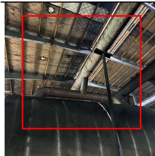
燃烧废气密闭收集
