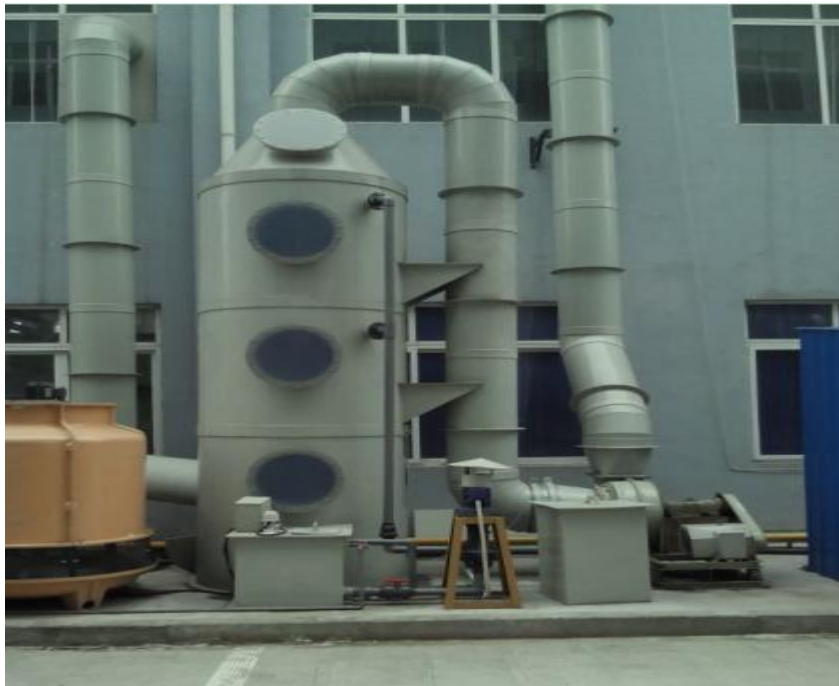
图 7.2-4 同类企业喷淋塔实景图
