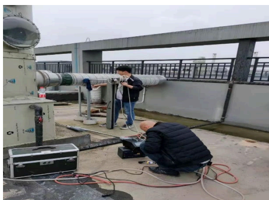
4 栋厂房喷淋塔处理设施
