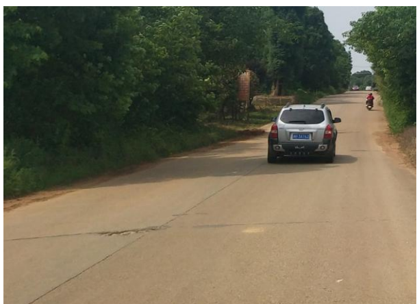
X011 路面坑槽
