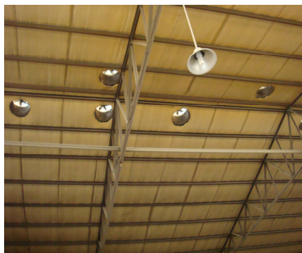
图 5-13 车间顶部排风扇
