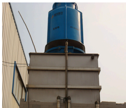
图 5-14 冷却水循环塔
